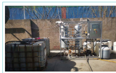
某兰炭废水项目
