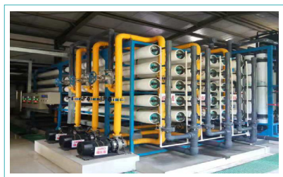
某冶金厂焦化尾水项目
