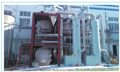
某园区废气项目
