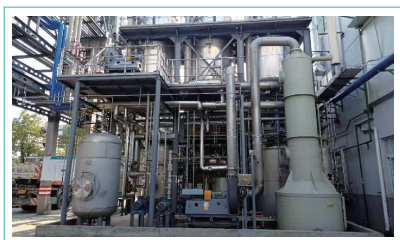
某园区废气项目
