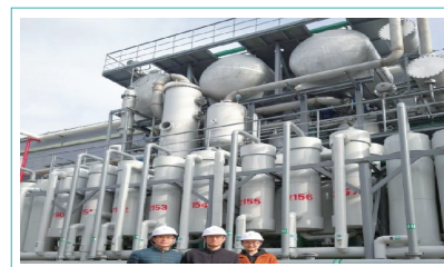
某医药企业废气项目
